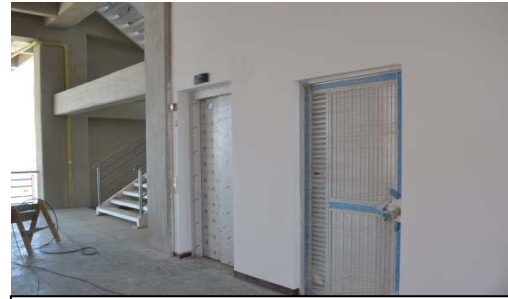
Ascensor y escaleras
