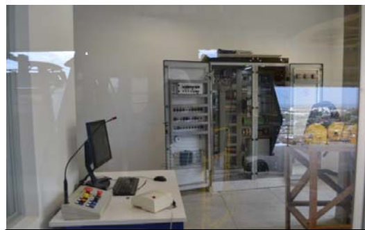
Cuarto del operador
